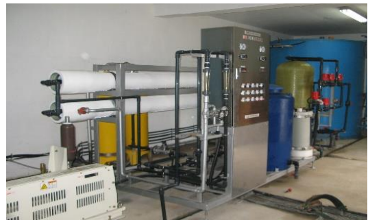
• 전남 나발도 해수담수화 장치 현장
