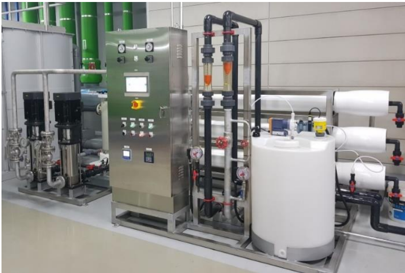
엘지유플러스 용산사옥 지하수 정수 장치 설치 및 관리 대행 현장
